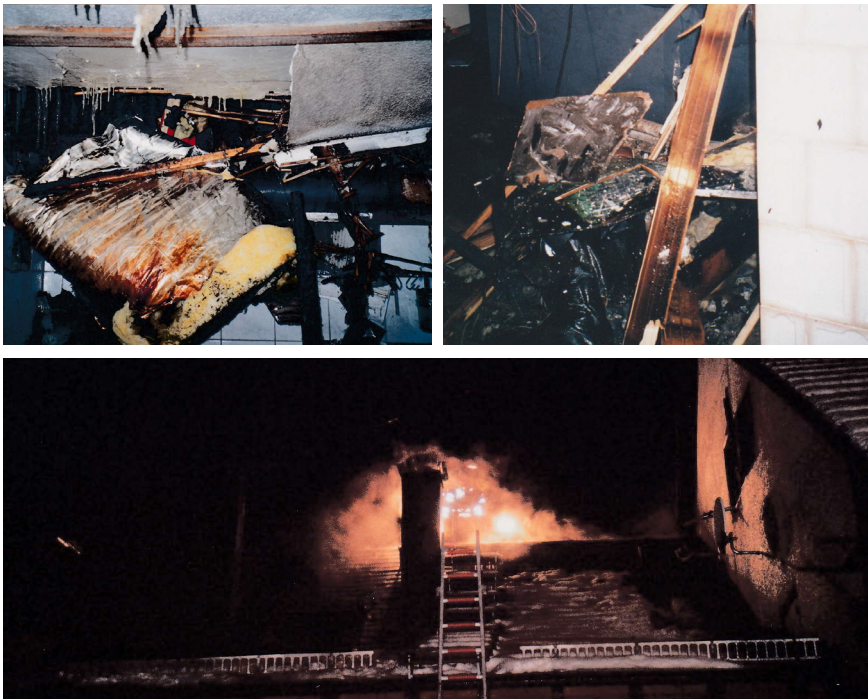
Januar 2002 - Gebäudebrand in Amstetten
